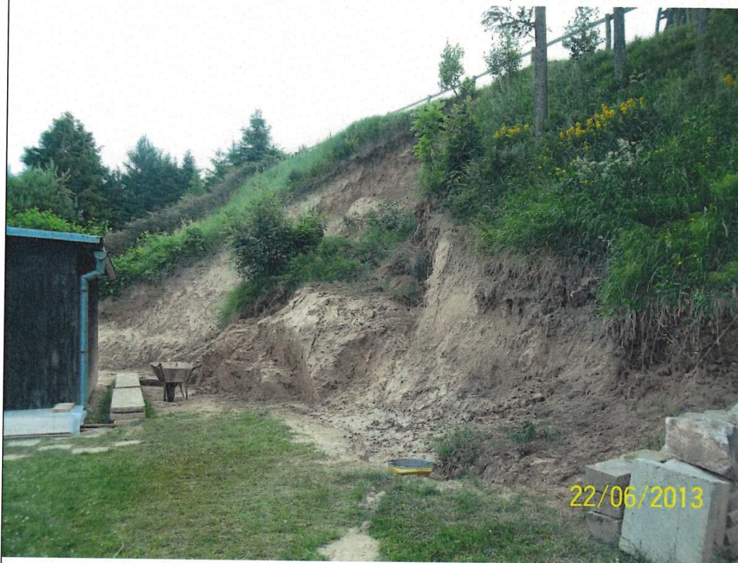
Foto 4. Widok osuwiska z częściowo uprzątniętym kolumwium w czerwcu w 2013 r. (zdjęcie udostępnione przez właściciela działki)
